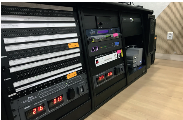
Der REF 10 und der iClock im Rack von Mischregie 2
